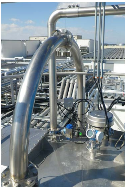
Transport pneumatique haut de silo
