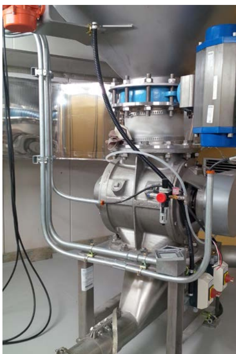
Transport en phase diluée par aspiration refoulement pour poudre
