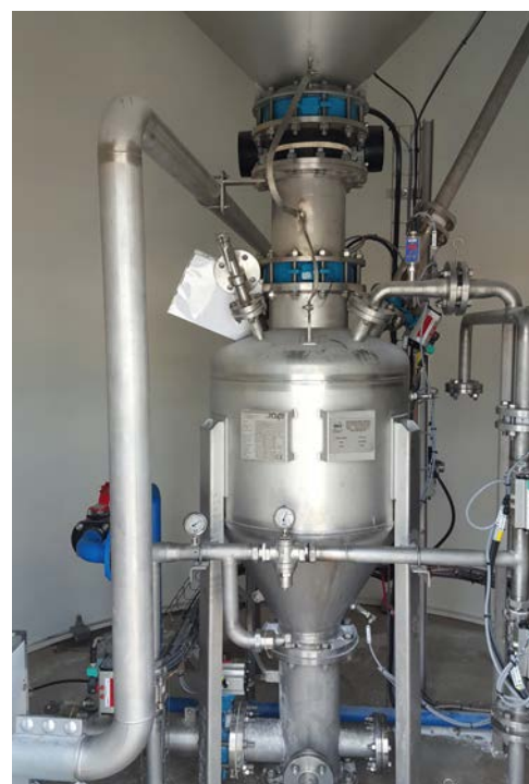
Transfert NEUPHASE par réservoir d'expédition
